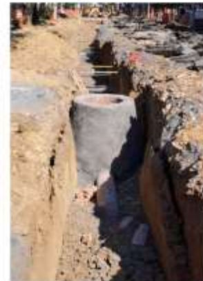
Habilitado de pozo línea sanitaria
